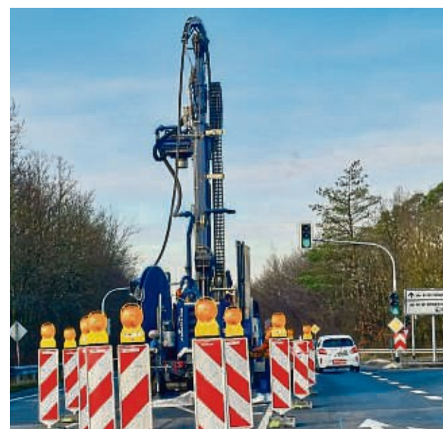
Eine aufwendige Gründungsbohrung lief gestern direkt auf dem Brückenkopf über die bestehende Bahntrasse.
